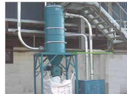
中央气泵 Central air pump
